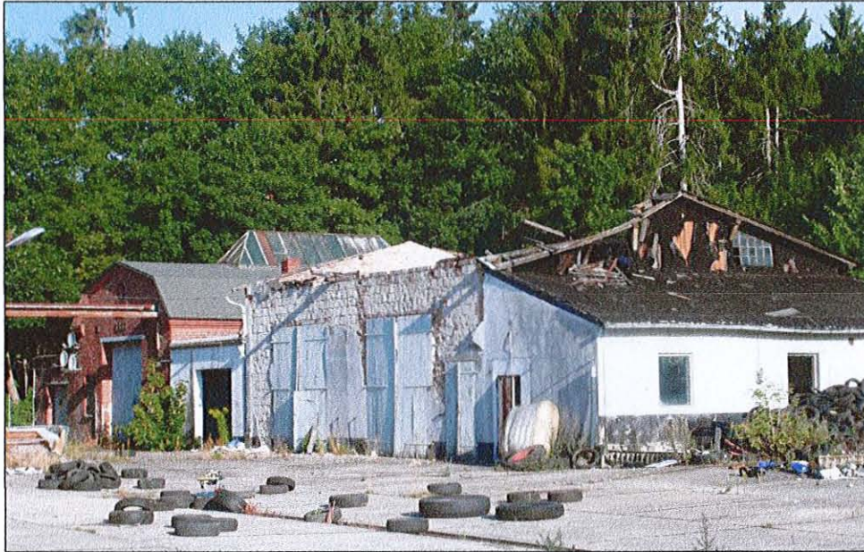
Abbildung 7: teilweise bereits eingestürztes Garagengebäude
