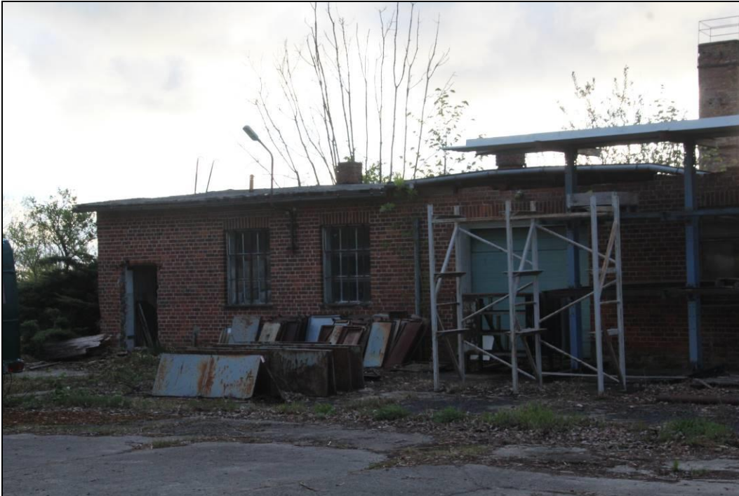
Abbildung 10: Ruine des eingeschossigen Werkstattgebäudes
