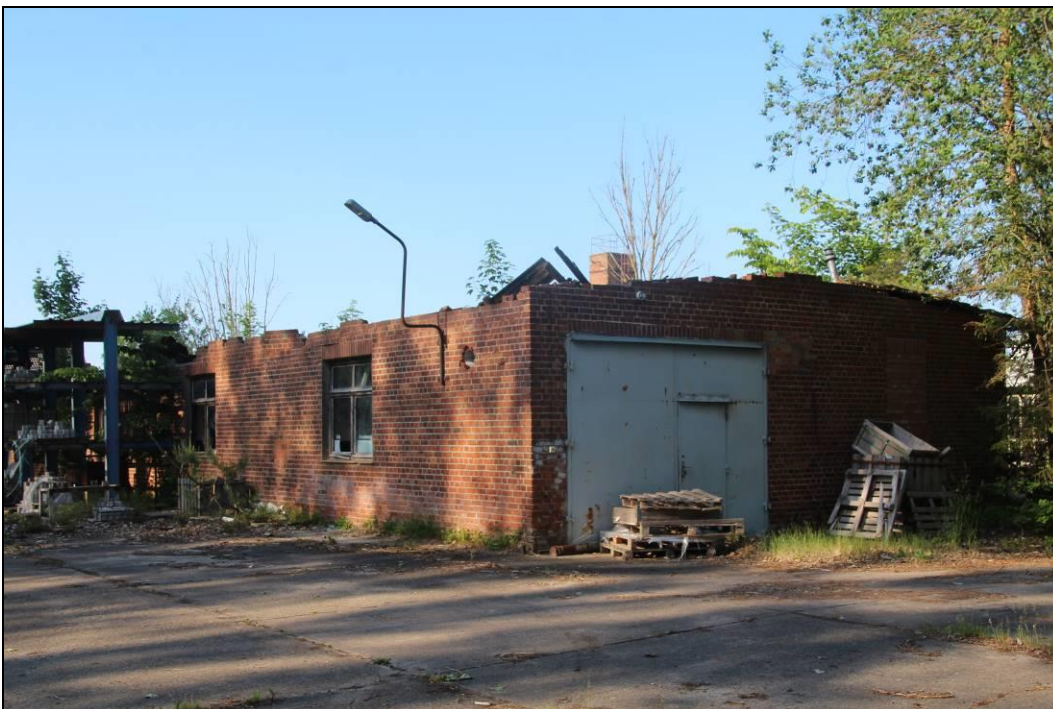
Abbildung 11: Ruine des eingeschossigen Werkstattgebäudes
