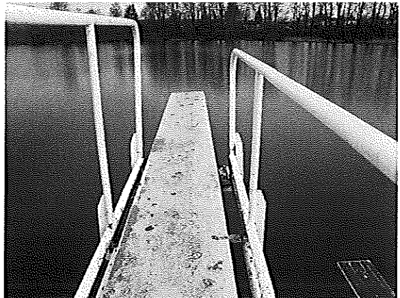
Geländer statt Brüstung vorhanden
