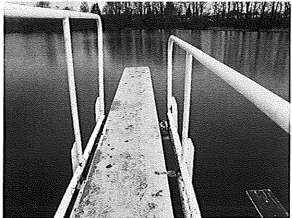
Geländer statt Brüstung vorhanden
