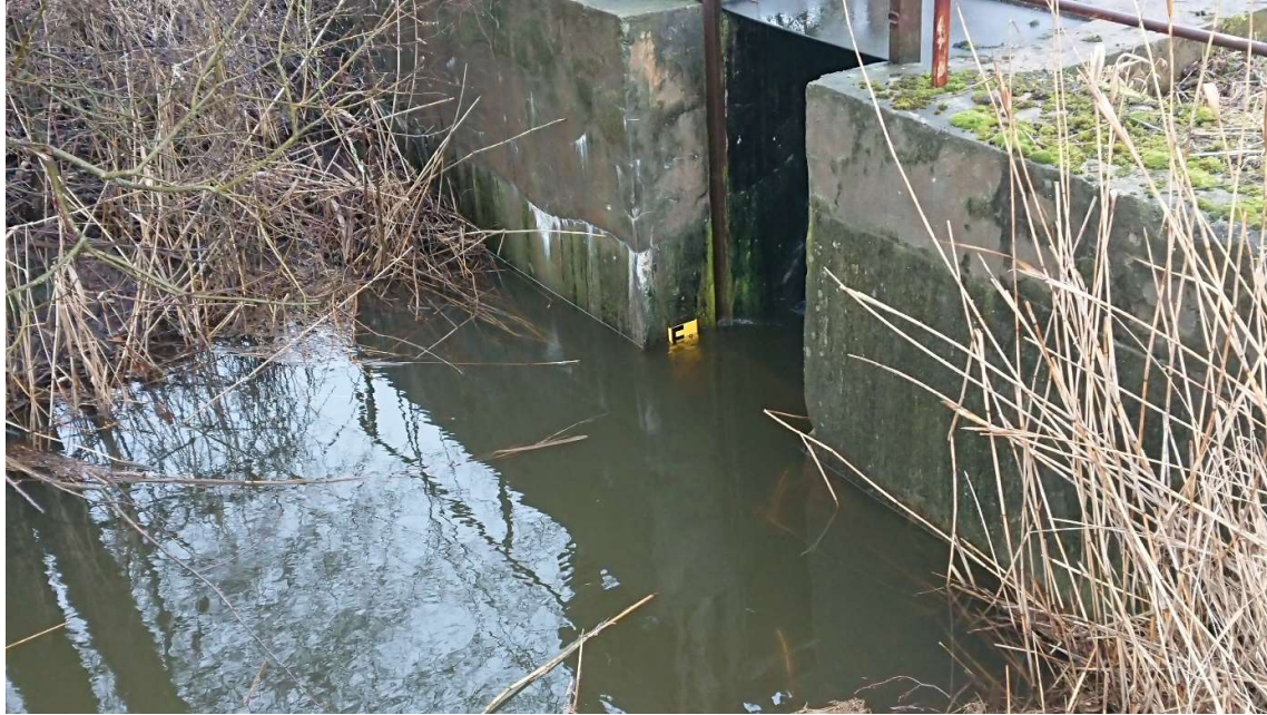
Abbildung 58: Stauwehr im Graben 22/6 am Fließkilometer 1+100 (Quelle: IaG GmbH)
