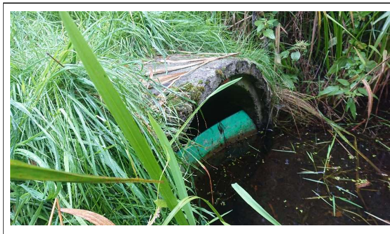
Abbildung 27: Stau im Graben 22/6 ca. 550 m unterhalb der Probenstelle 2 am 18.07.2023 (Quelle: IaG GmbH)
