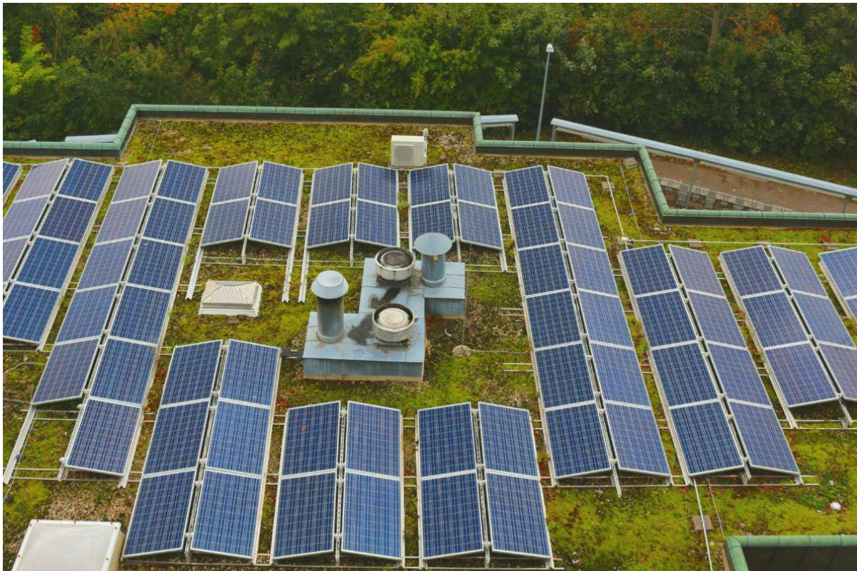
Abb. 12: Aufgeständerte PV-Anlagen auf einem Gründach, Quelle: https://www.enbw.com/blog/energie-wende/solarenergie/photovoltaik-auf-dem-flachdach-geht-das/
