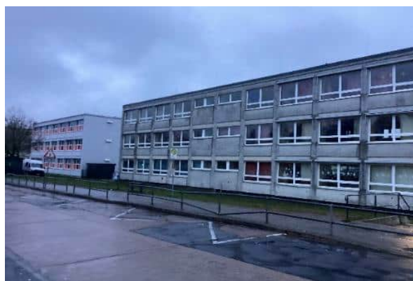
Abbildung 74: Fassadenbeeinträchtigungen am westlichen Grundschulgebäude am Ploggenseering
