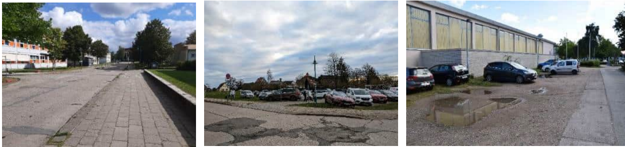
Abbildung 78: Fahrbahn-/Oberflächenzustand in Höhe des Schulbereichs sowie an der Sport- und Mehrzweckhalle
