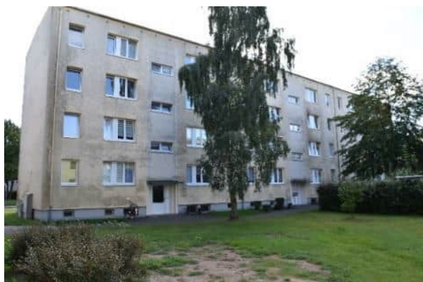
Abbildung 73 Ansicht Zustand Wärmedämmfassade
