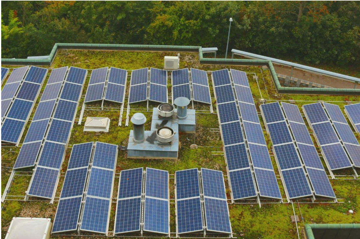
Abb. 12: Aufgeständerte PV-Anlagen auf einem Gründach, Quelle: https://www.enbw.com/blog/energie-wende/solarenergie/photovoltaik-auf-dem-flachdach-geht-das/
