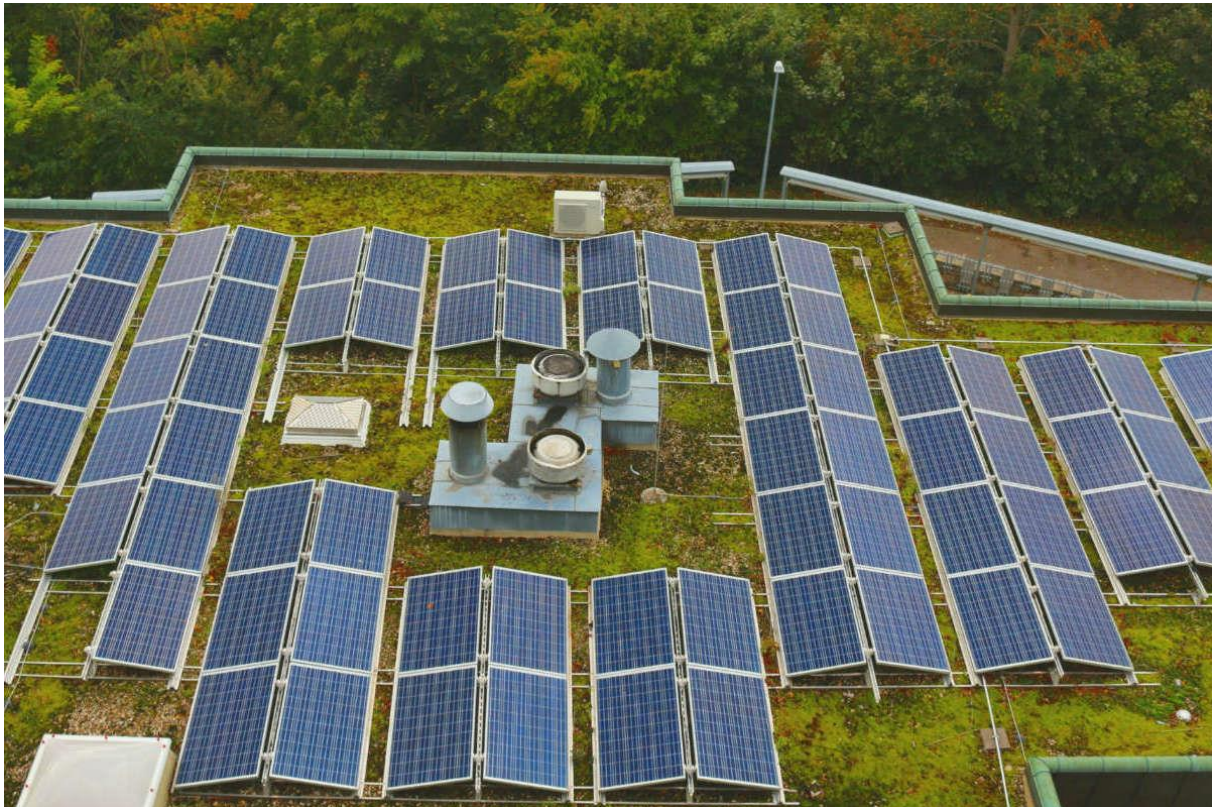
Abb. 10: Aufgeständerte PV-Anlagen auf einem Gründach, Quelle: https://www.enbw.com/blog/energie-wende/solarenergie/photovoltaik-auf-dem-flachdach-geht-das/
