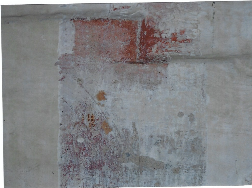
Foto 6 und 7; Südwand – Freilegungsprobe unten rechts, Bordüre und rotes Band entlang der Putzkante, liegt auch auf der Fase der Putzkante
