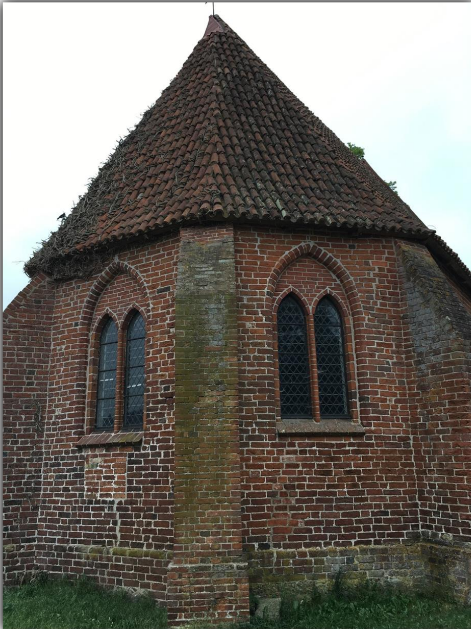
Kapellenschiff im Osten, Dachdeckung verschlissen, verwittert, Teilabbrüche, Undichtigkeiten
