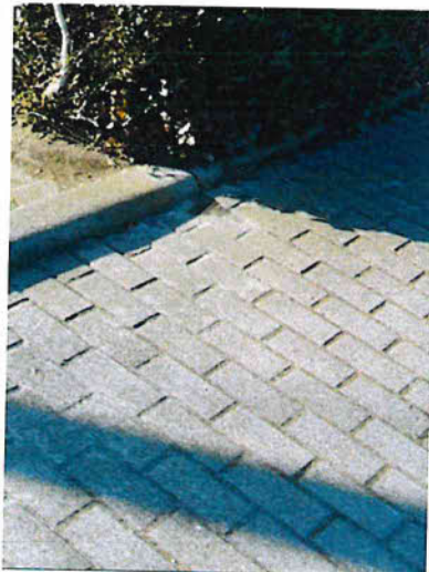
Abb.21: 9480 – Unebenheiten im Pflasterbelag
